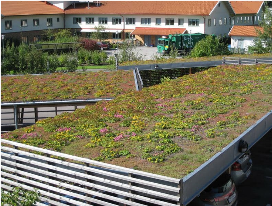
Figur 25. Grönt sedumtak på en garagebyggnad i Kungsbacka (Bildkälla: VegTech AB).
